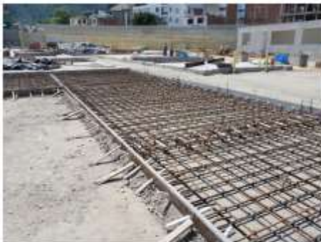
Suministro e Instalación de acero de refuerzo Pavimentos en concreto Hidráulico para patio taller
