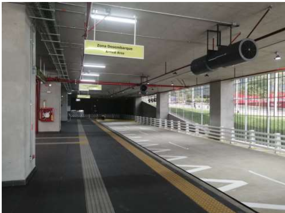
Pruebas extractores de monóxido e iluminación troncales
