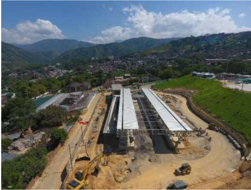
Vista Panorámica avance de obra instalación de cubiertas en estación de transferencia y construcción de vía de acceso
