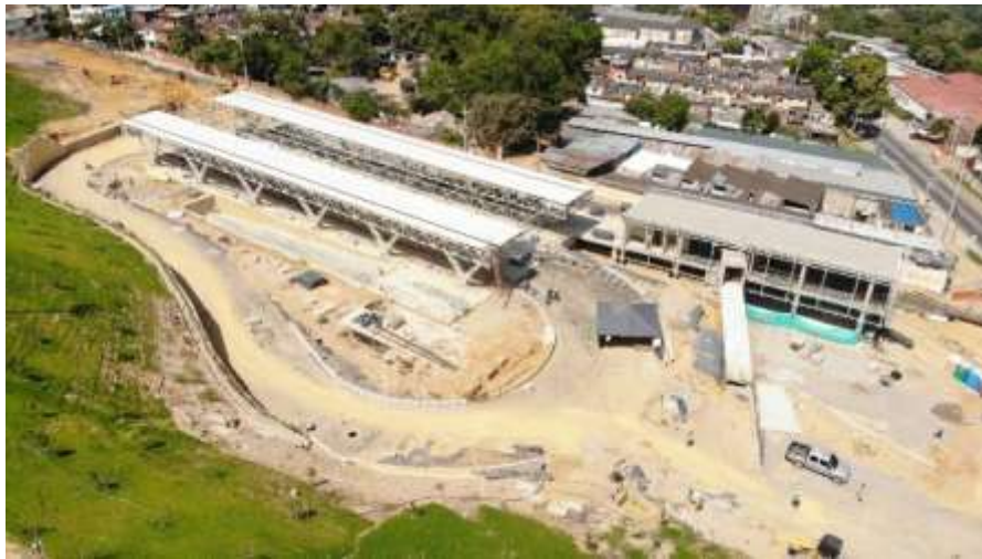
Vista panorámica avance de obra estación de transferencia, vías internas, equipamiento y plaza de acceso
